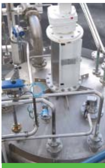
Un agitateur monté sur une cuve de régénération de solvants. Le réducteur SEW-USOCOME, que l'on voit au sommet de l'installation, est à engrenages cylindriques de type RF.
